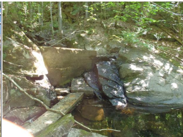
Bilde: Oppgangshinder, gammel vannverksdam
