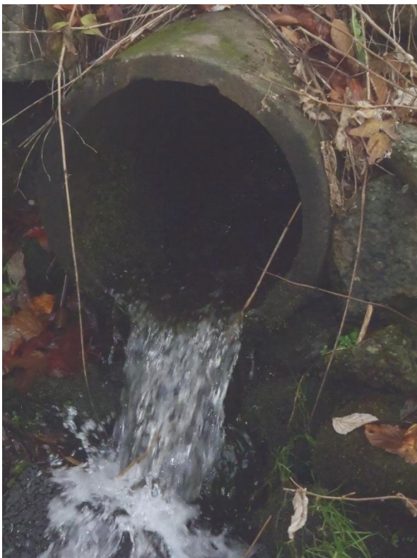
Bilde: Rør høyt i veifylling er oppgangshinder
