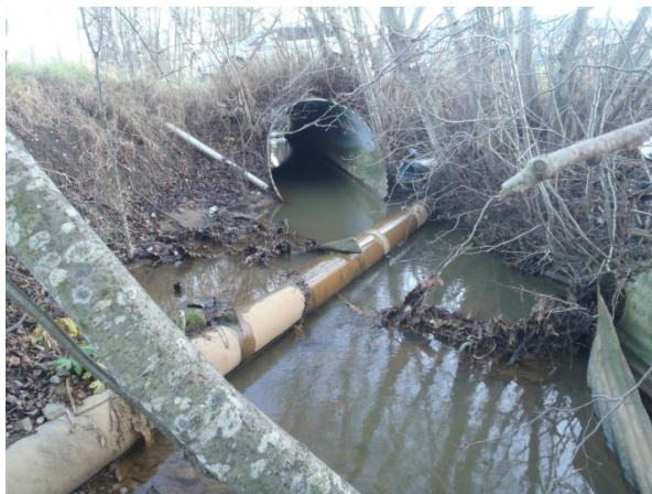
Bilde: Kloakkrør, oppgangshinder
