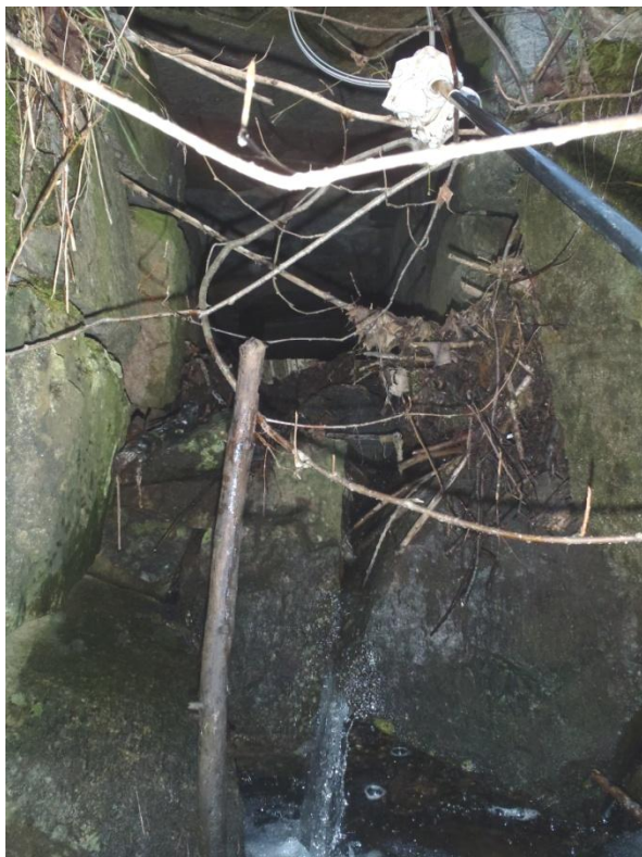
Bilde: Delvis gjenrast kulvert, oppgangshindrende effekt
