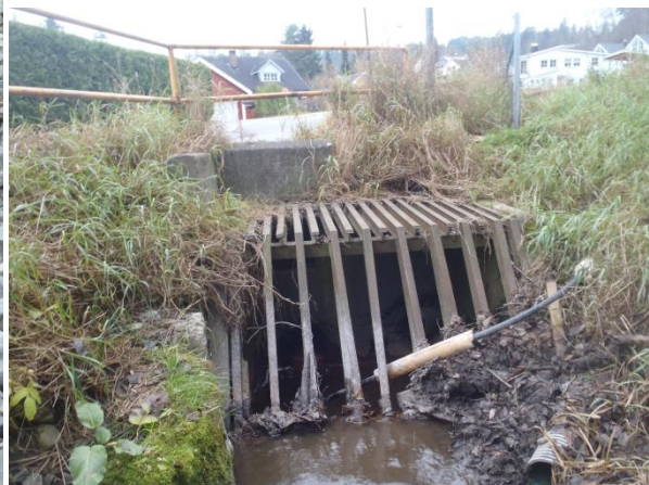
Bilde: Inntaksristtil rør, oppgangshinder
