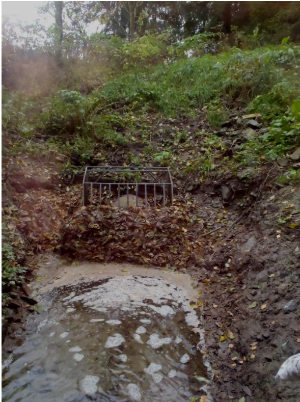
Bilde: Inntaksgitter er en uheldig utforming som lett danner et høydesprang
