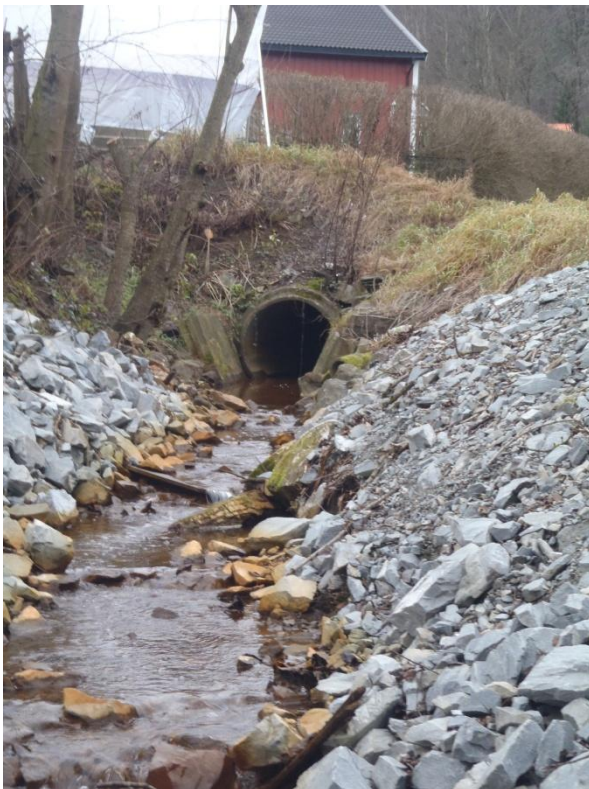
Bilder: Oppgangshinder, rør med ca 70 meter lengde
