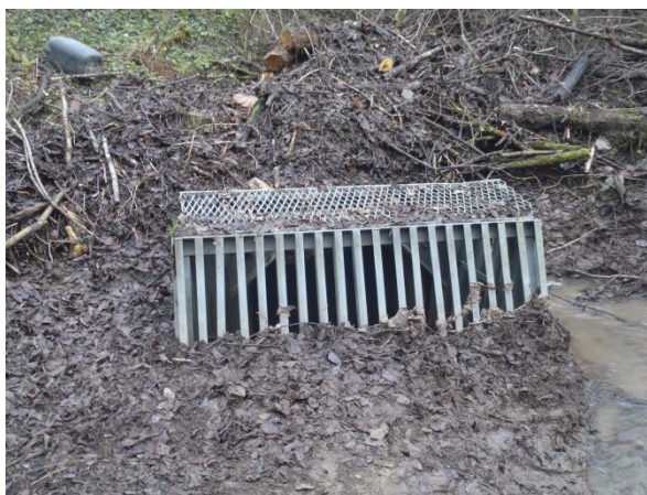
Bilde: Oppgangshinder, rist oppstrøms side
