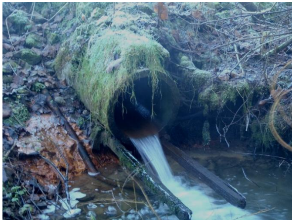
Bilde: Oppgangshinder i nord østre bekkeløp
