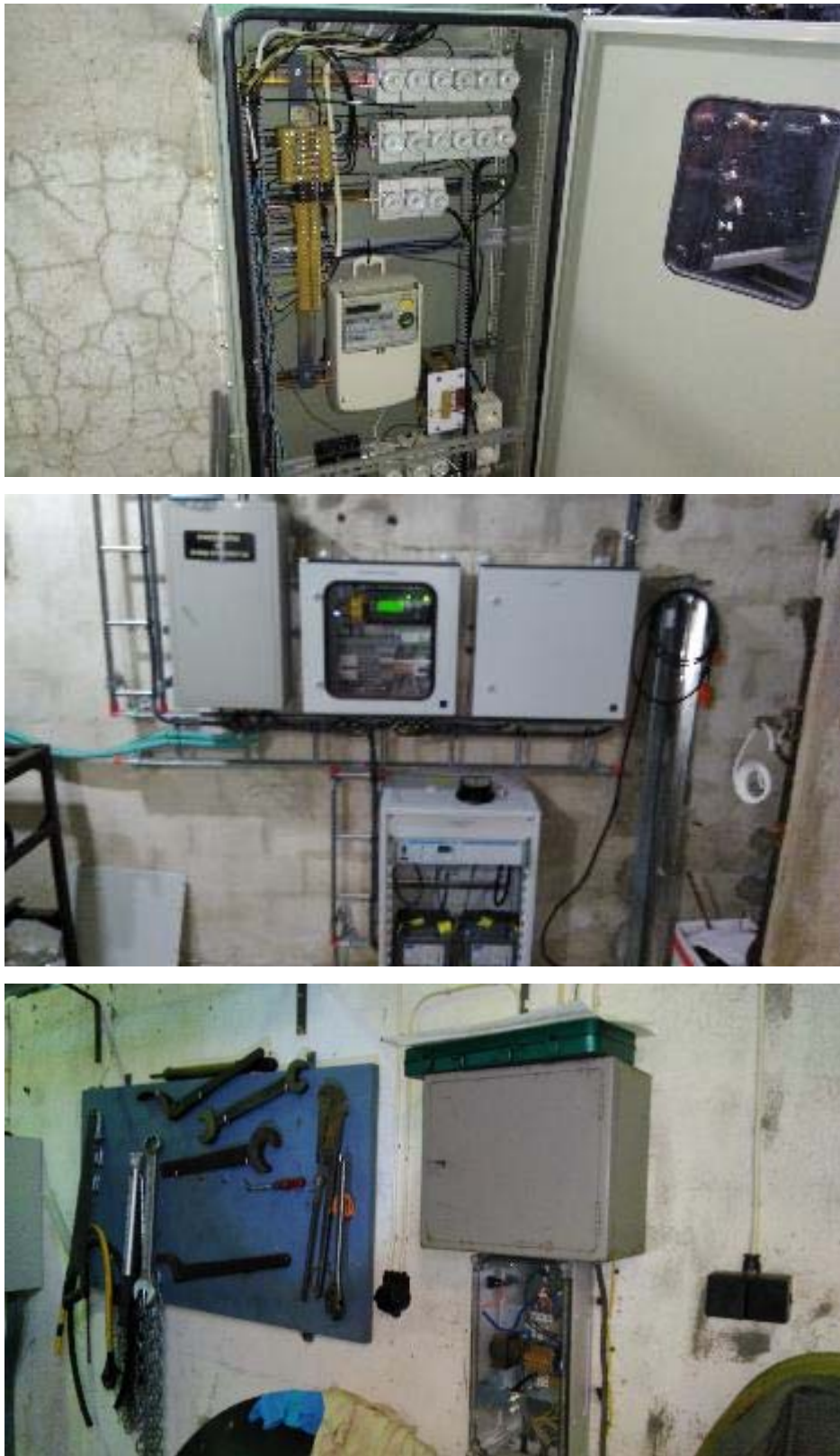
Figur 8: Bilder av el-bokser, sikringsskap, ledninger og el-installasjoner. Alt EE-avfall skal sorteres ut og leveres som egen fraksjon til godkjent mottak
