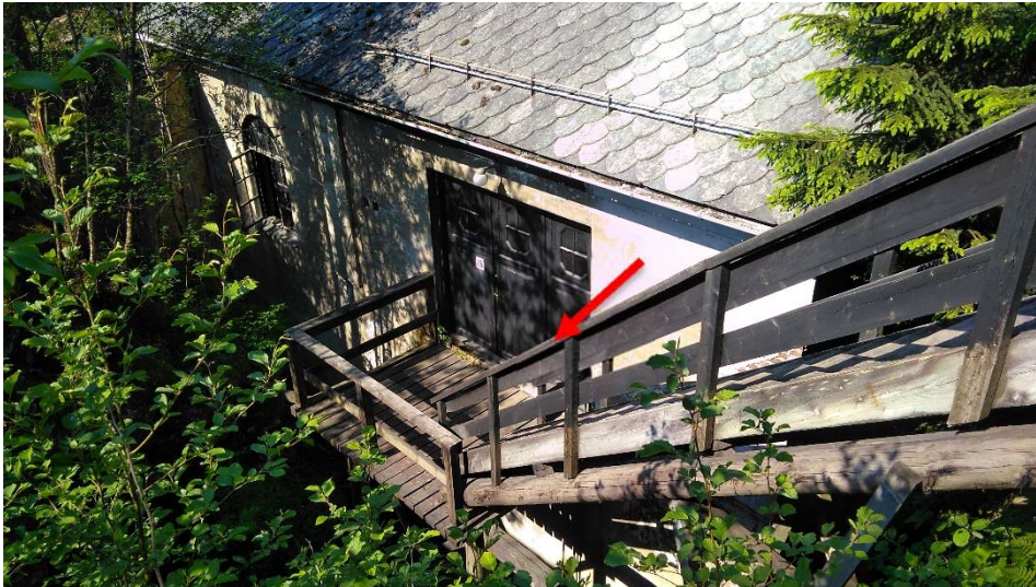
Figur 10: Trapp ned til kraftstasjonen inneholder CCA- og kreosotimpregnerert trevirke.
